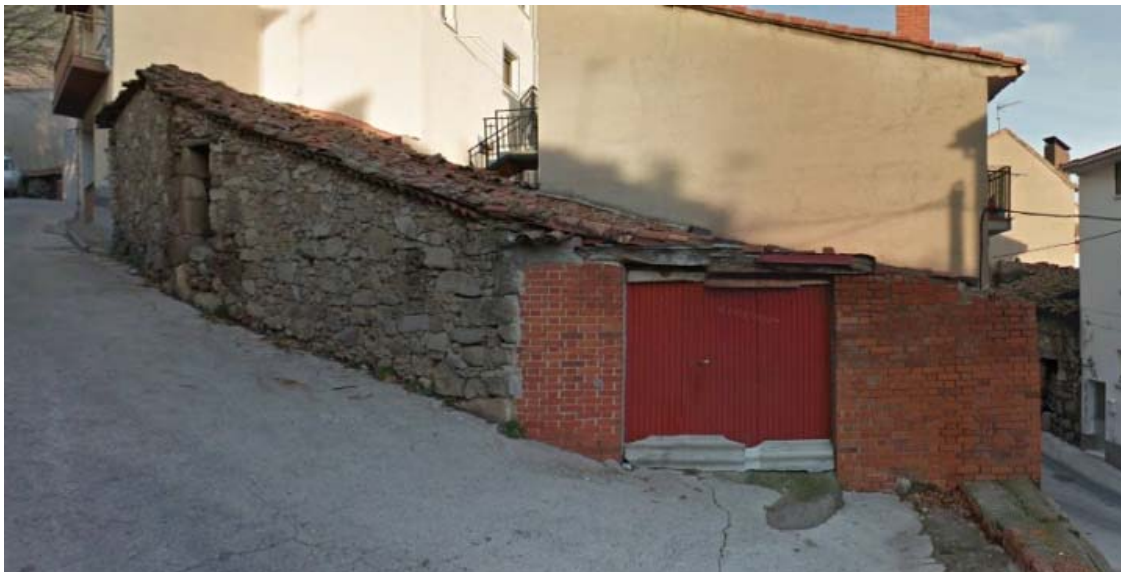
Los muros de mampuestos se curvan por el uso de piedra sin labrar.
